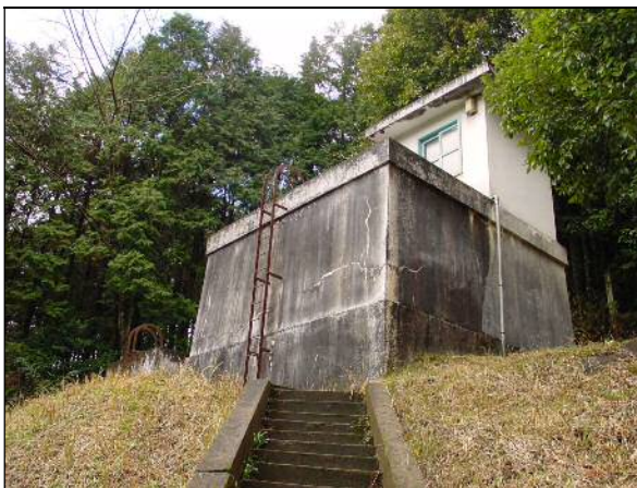
図 3-2. 石井配水池(昭和 49 年度築造)
