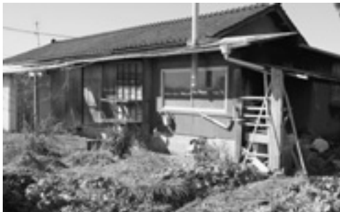
老朽化した市営住宅
