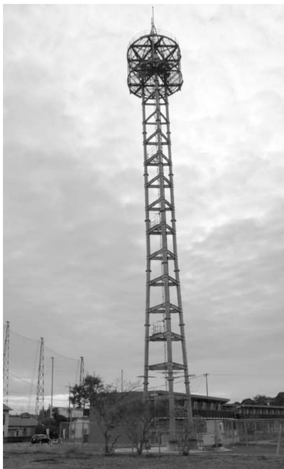
設置されている鉄塔
