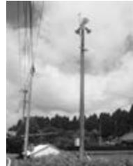
防災無線の吹鳴
