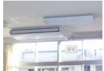
湯之尾小学校に設置されたエアコン
