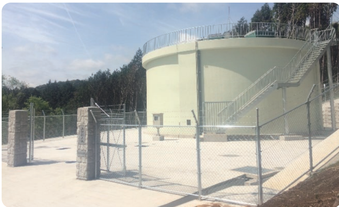
市水道の配水池
