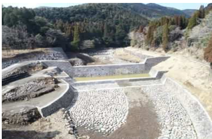
新燃岳の噴火対策で整備中の霧島川 11号えん堤（2023年3月完成予定）
