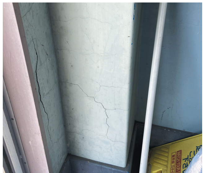
あらゆる場所にひび割れが
